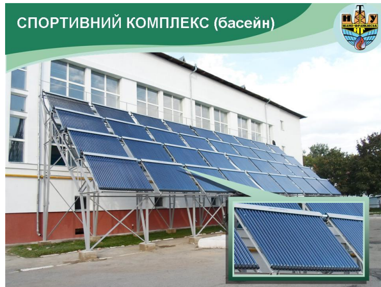
Рис. 6. Сонячна теплова станція
